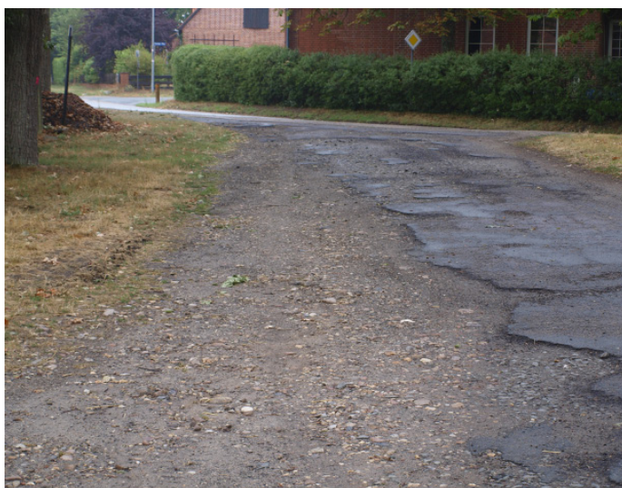
Abb. 28: Straße mit Sanierungsbedarf in Helmerkamp Quelle: Eigene Abbildung
